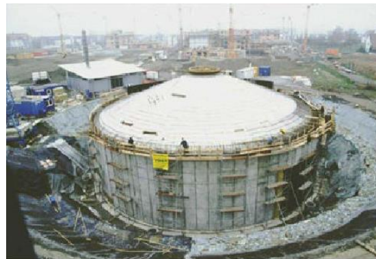
Stockage saisonnier d'eau de 12 000 m 3 de Friedrichshaffen en Allemagne (source CEREMA)
